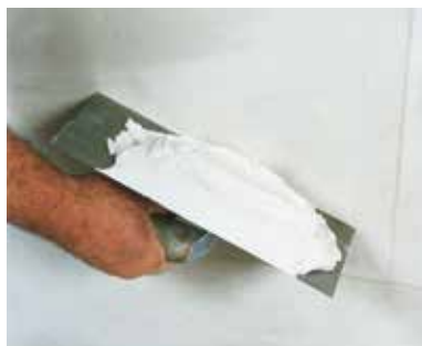
De släta Ytong Väggelementen kan tapetseras efter en enkel, snabb spackling eller putsning.
